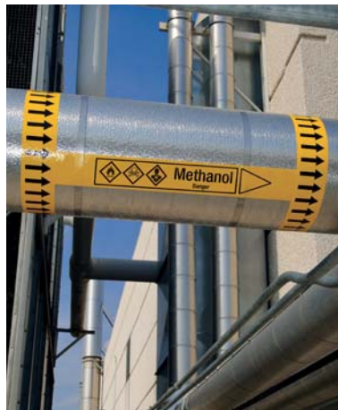
Marquage de tuyauteries
